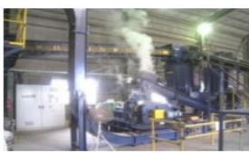
固形燃料化施設
