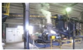
固形燃料化施設
